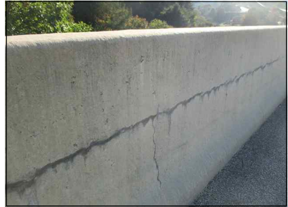
방호벽 균열부 백태(S3)
