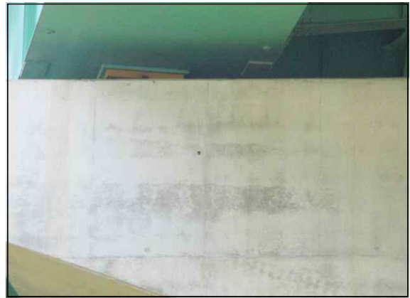
교각 코핑부 균열(P3)
