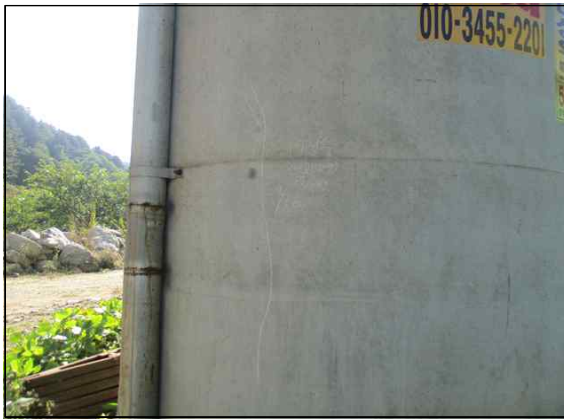
교각 기둥부 균열(P1)
