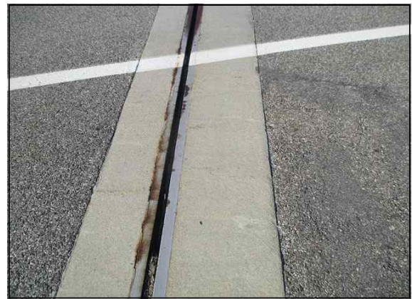
신축이음 후타재 균열(A2)
