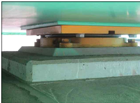
받침콘크리트 균열 (P1 SH1)
