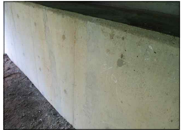
교대 균열보수 현황(A2)
