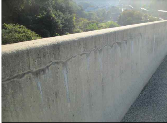
방호벽 균열부 백태(S2)
