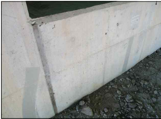
교대 균열보수 현황(A1)
