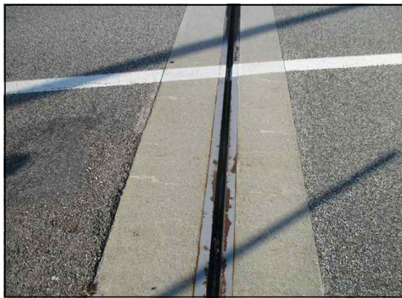
신축이음 후타재 균열(A1)
